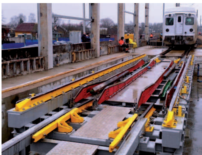
Rys. 3. Stanowisko przestawcze w stacji Brest Centralny (Białoruś) [fot. M. Lalik]
